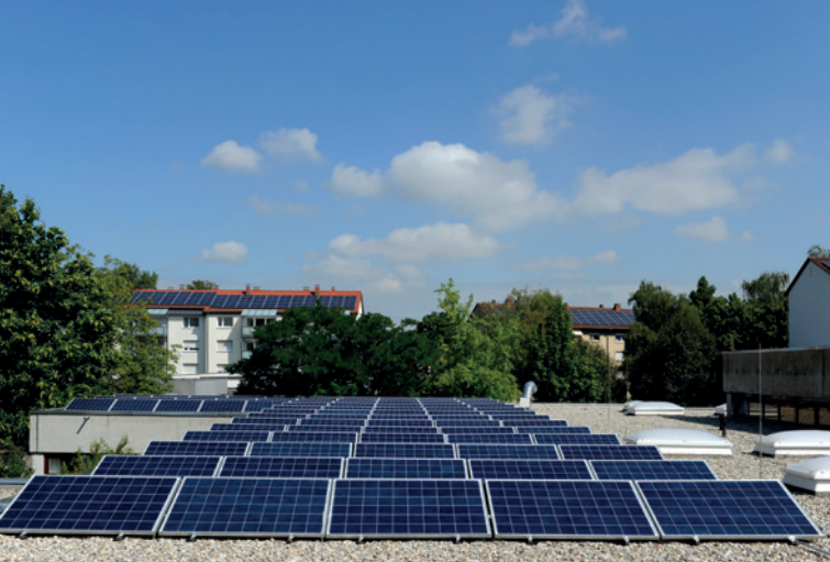
Photovoltaik-Kundenanlage auf der Quartiersmensa plus St. Hedwig
